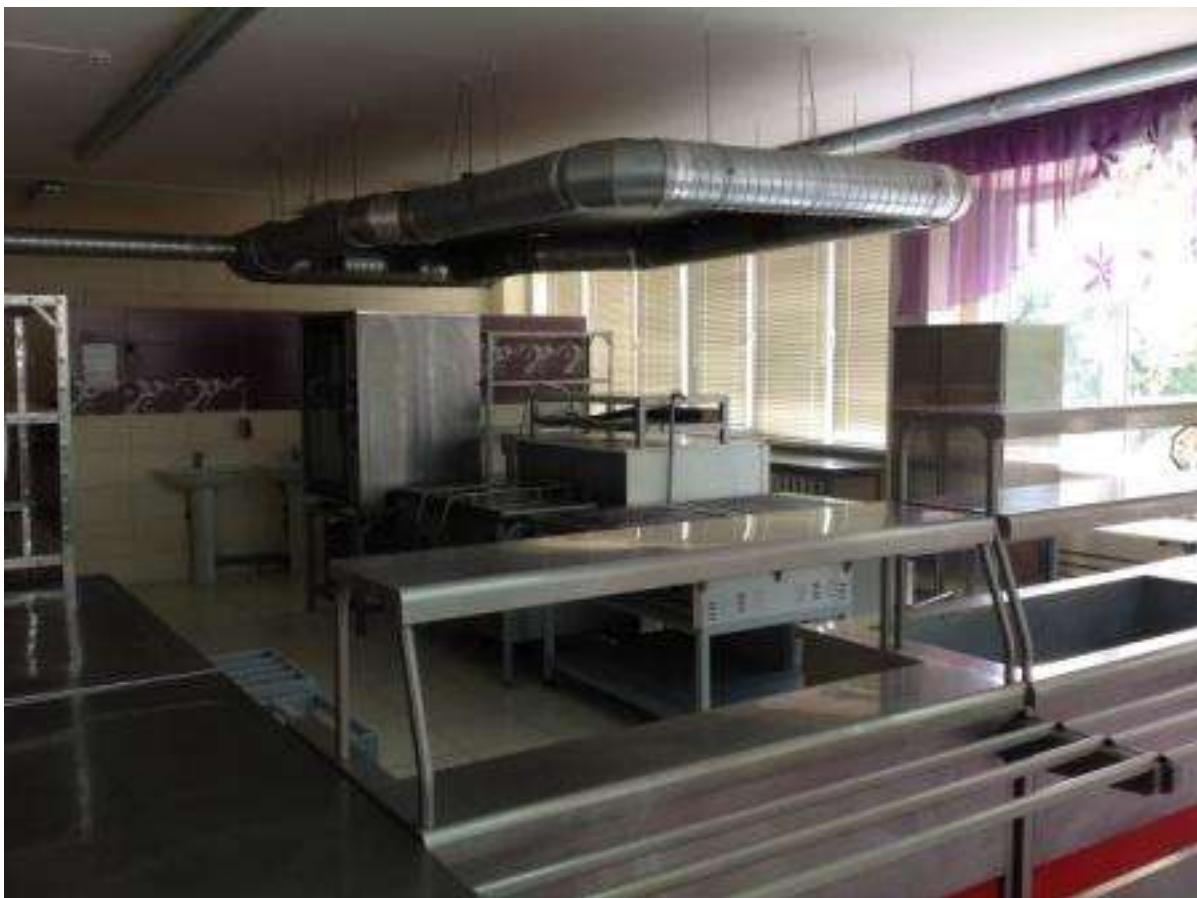
Оснащение пищеблока технологическим оборудованием
